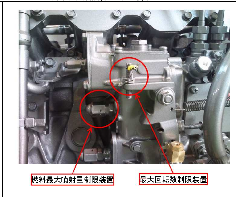
封印状況(制限装置カラー写真)
