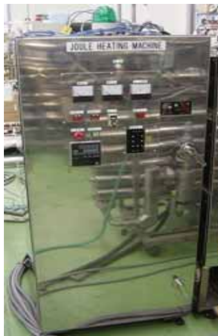
図Ⅲ.3-11 電源装置
