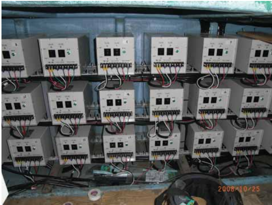
図Ⅲ.2-9 安定器設置室
