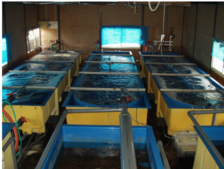
図 2.2-2 省エネ実証設備
