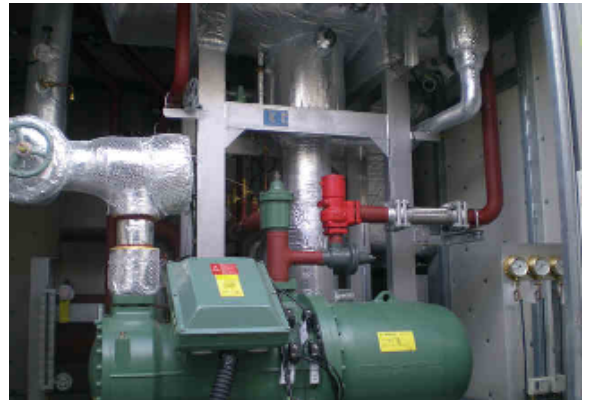
図Ⅲ. 2-10 ヒートポンプ部
