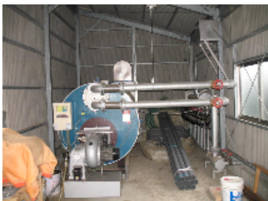
図Ⅲ.2-1 既存重油焚きボイラー
