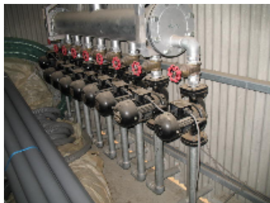
図Ⅲ.2-2 各池温水循環ポンプ
